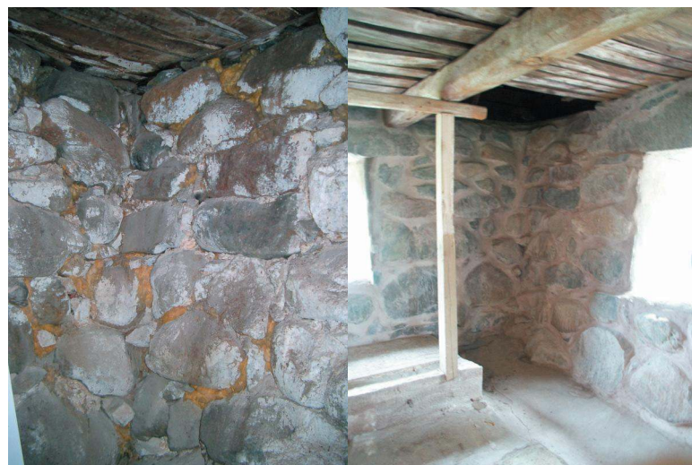
Vasemmalla korjaamatonta navetan seinää. Muuri oli käynyt hataraksi ja vetoisaksi laastisaumojen rapautumisen vuoksi. Myös eristehiekkaa oli valunut ulos seinästä. Oikealla on sama kohta korjattuna kalkkisementttilaastilla. Navetta on 1900-luvun alkupuolelta. (Brusila, li)
