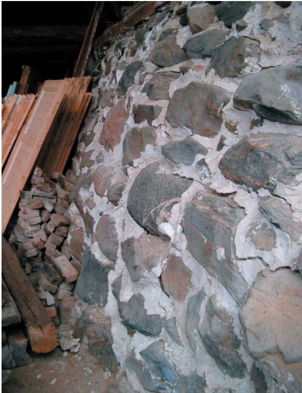
Seinämuurin pullistuma. Tässä tapauksessa vaurio on syntynyt navetan päädyn purkamisesta, jolloin sisäpuolinen muuri on lähtenyt erkaantumaan ulkomuurista. Korjaaminen voi tapahtua purkamalla ja muuraamalla vauriokohta uudelleen, mutta koska vaurio on kertaluonteinen eikä etene, voidaan lievä pullistuma jättää myös ennalleen kunhan päädyn korjaamisesta muutoin huolehditaan. (1800-luvun alunperin laastitsematon särkykivinavetta. Mäenpää, Kiiminki)
