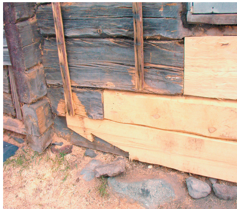
Kuva: Alin hirsi on liitetty vanhaan hirteen vetoa kestävällä hammaslapaliitoksella. Yläpuolella hirret on liitetty sormiliitoksella.
